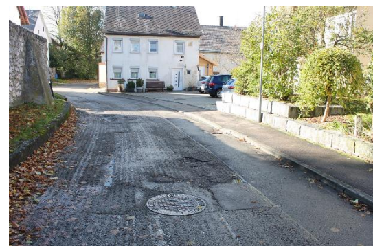
Abbildung 30: Pfarrgasse, mangelhafter Zustand der Straße (Quelle: WHS, 2022)
