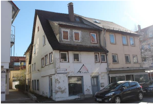
Abbildung 17: Weite Straße, Gebäude mit Substanzmängeln (Quelle: WHS, 2022)
