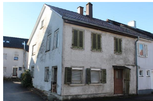
Abbildung 16: Weite Straße, Gebäude mit Substanzmängeln (Quelle: WHS, 2022)
