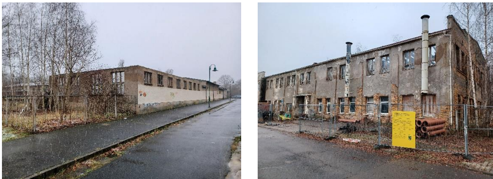
Abb. 1: Ehemalige Gewerbebauten schwerpunktmäßig von baulichen Mängel betroffen
